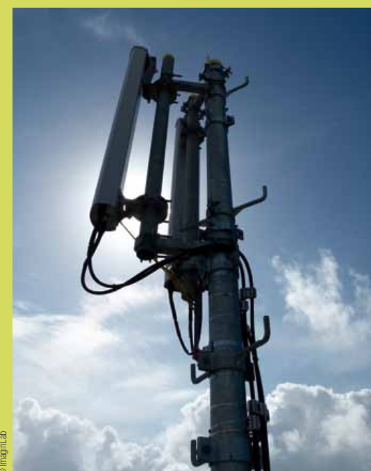
Antenne installée à Télécom Bretagne
